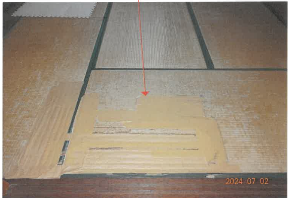
⑤ (1階中央和室 畳損傷箇所)
