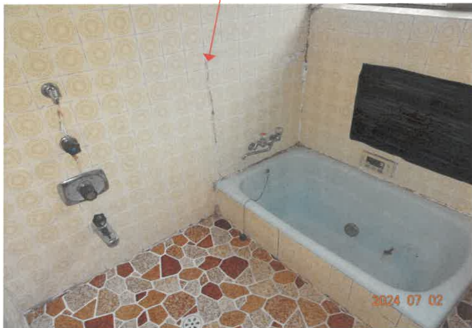
⑦ (1階浴室 クラック補修箇所)
