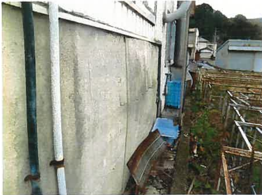
5 外壁が 曲がって いる 状況
