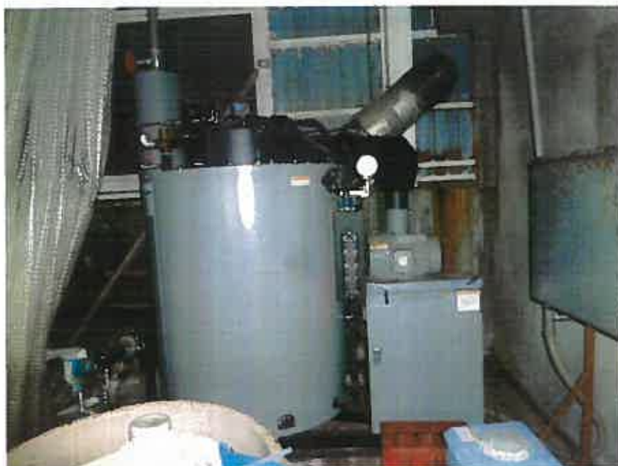
13 同上 ボイラー
