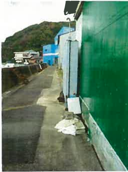
4 タンクが はみ出し ている状況
