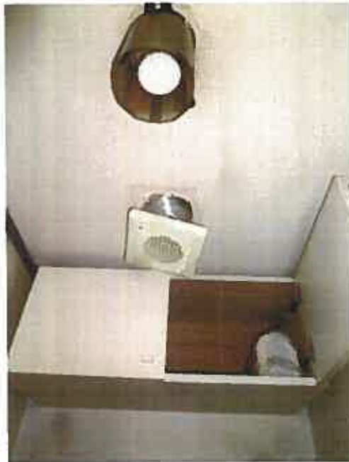
8 トイレ天井 の換気扇
