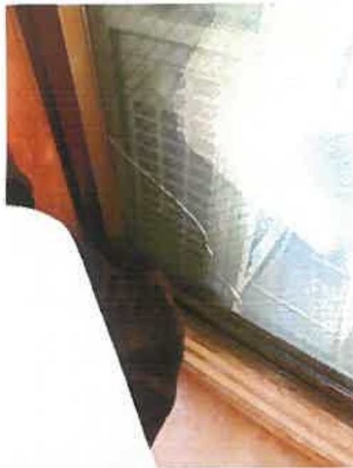
16 同上 ガラスの 破損
