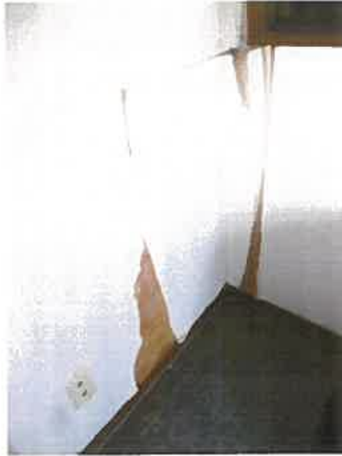
4 同上 壁の汚れ
