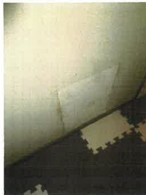
9 廊下の 壁の傷
