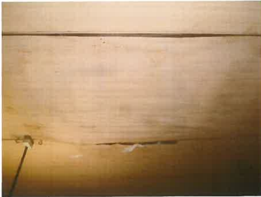
7 同上 雨漏り跡
