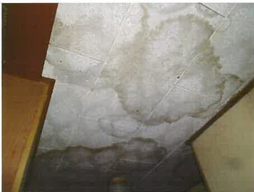
11 廊下の 天井の 雨漏り跡
