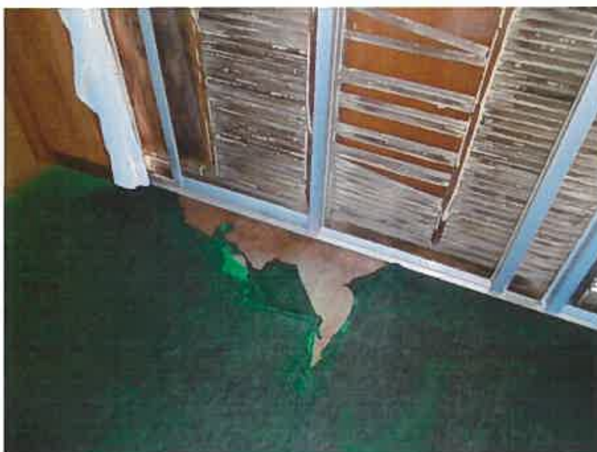
17 同上 雨戸と 床の損傷
