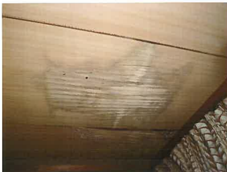
21 2F 廊下 雨漏り跡
