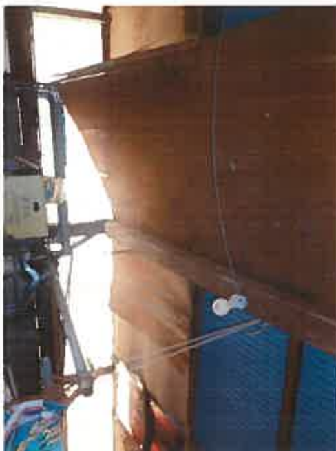
15 同上 壁が一部 剥がれて いる状況
