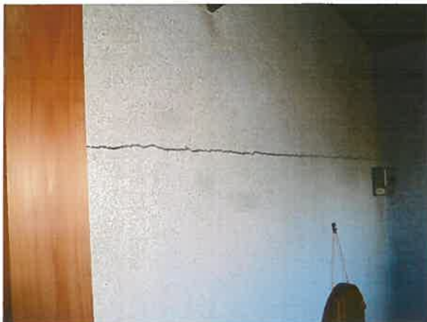
4 同上 壁の ひび割れ
