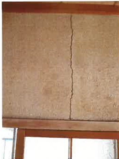
20 同上 壁の ひび割れ
