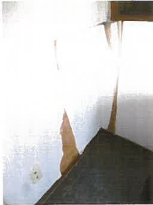
4 同上 壁の汚れ
