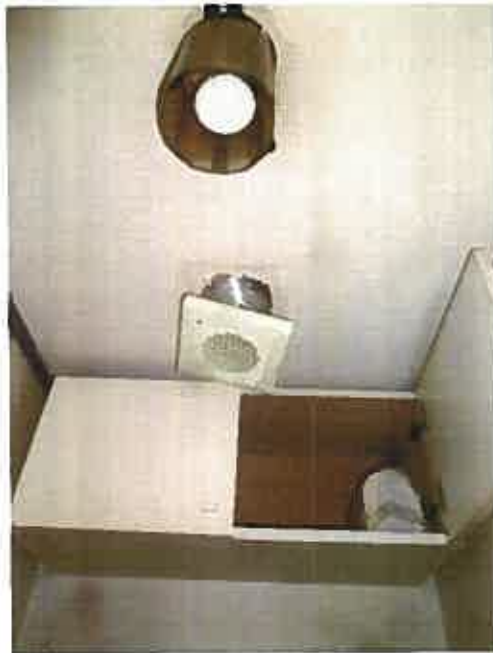
8 トイレ天井 の換気扇
