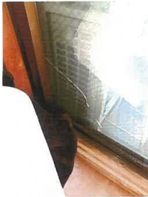
16 同上 ガラスの 破損
