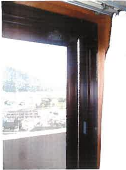
13 同上 網戸の 隙間
