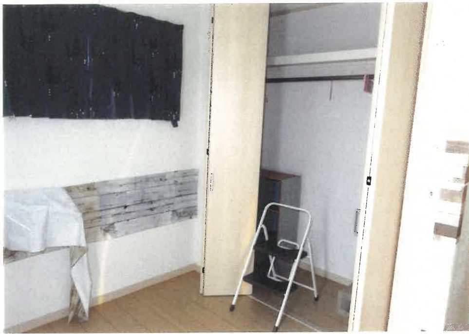
⑤ 屋内の状況（洋室1のクロスの表面の粉の落下を防ぐためシートが貼られている様子）
