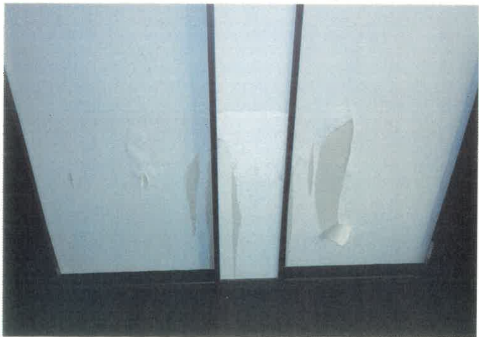
⑩ クロスの損傷状況（リビング・ダイニング・キッチン）
