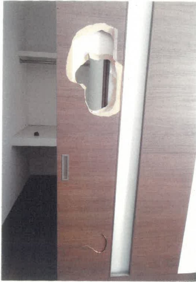
⑨ 扉の損傷状況（ウォークインクローゼット）
