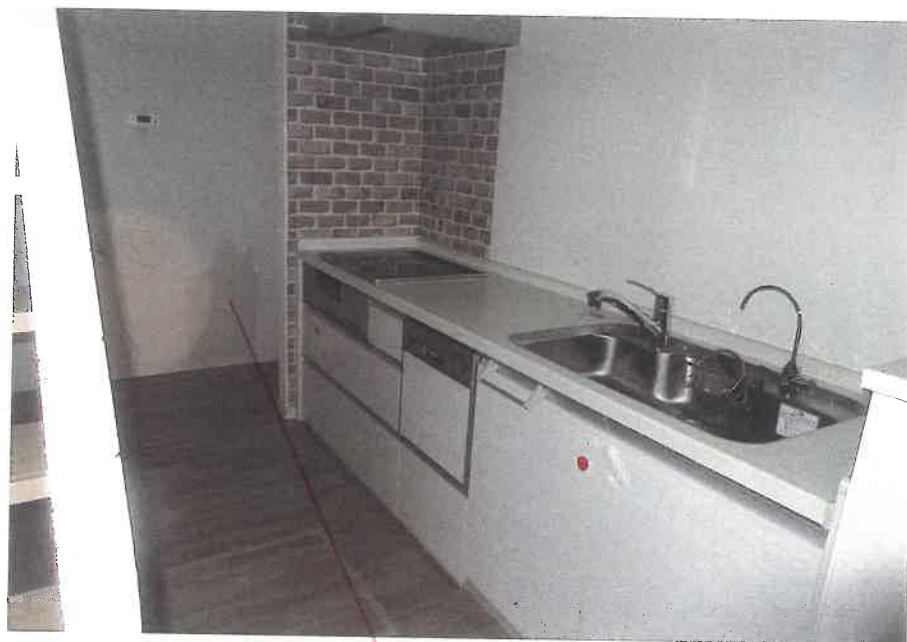
壁のクロスの損傷の状況
