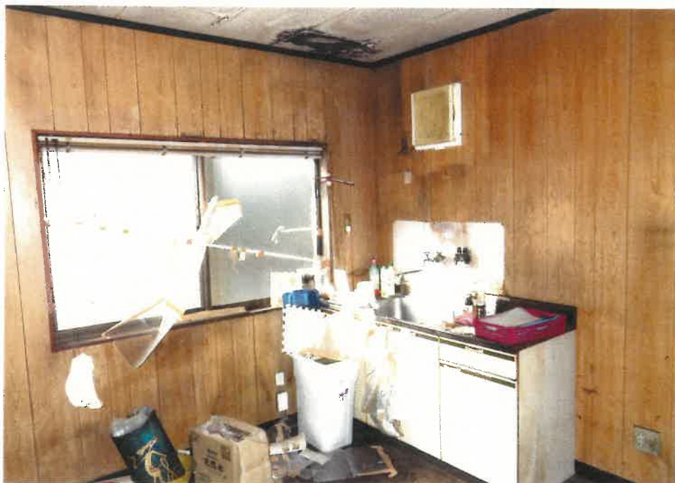
⑥ 屋内の状況（物件2建物附属建物（2階事務所（給湯））
