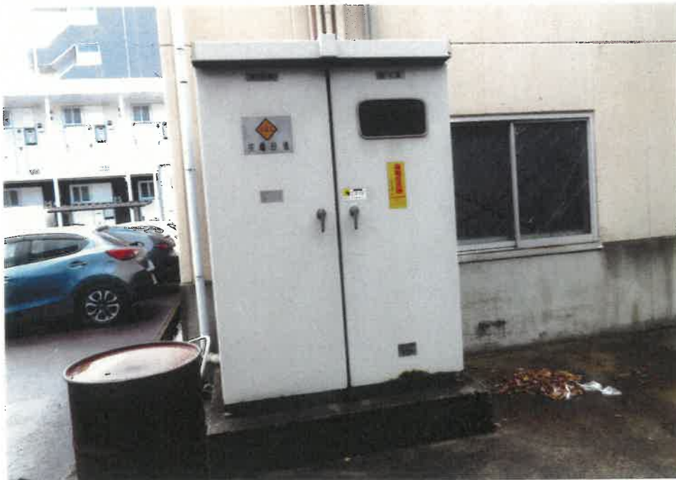
⑧ 変電設備の様子 （2枚目）
