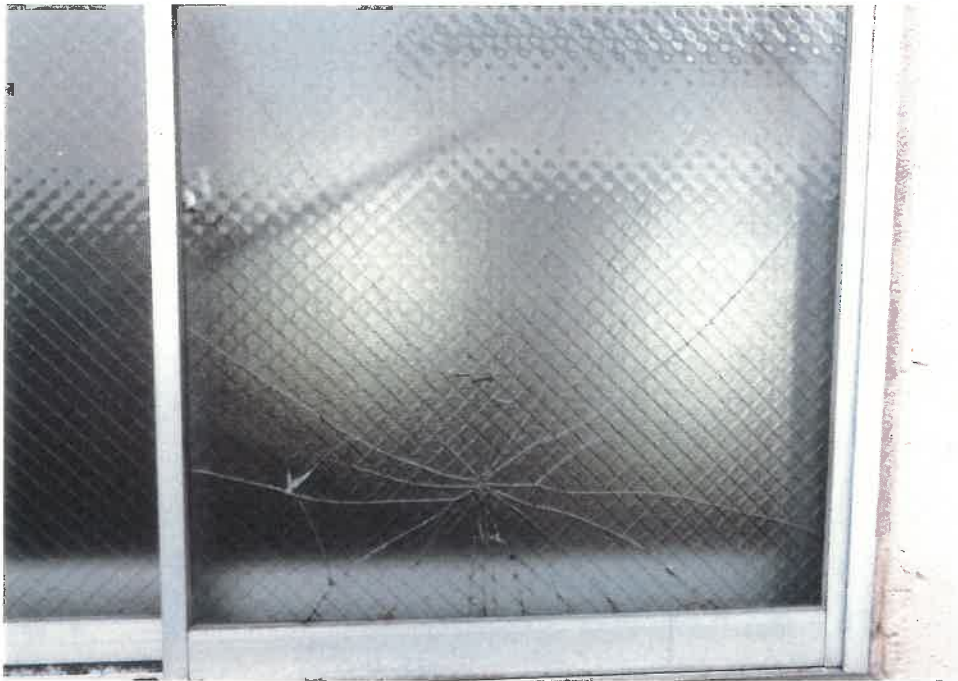
⑦ 物件2建物主である建物（ガラスにひびが入っている様子）
