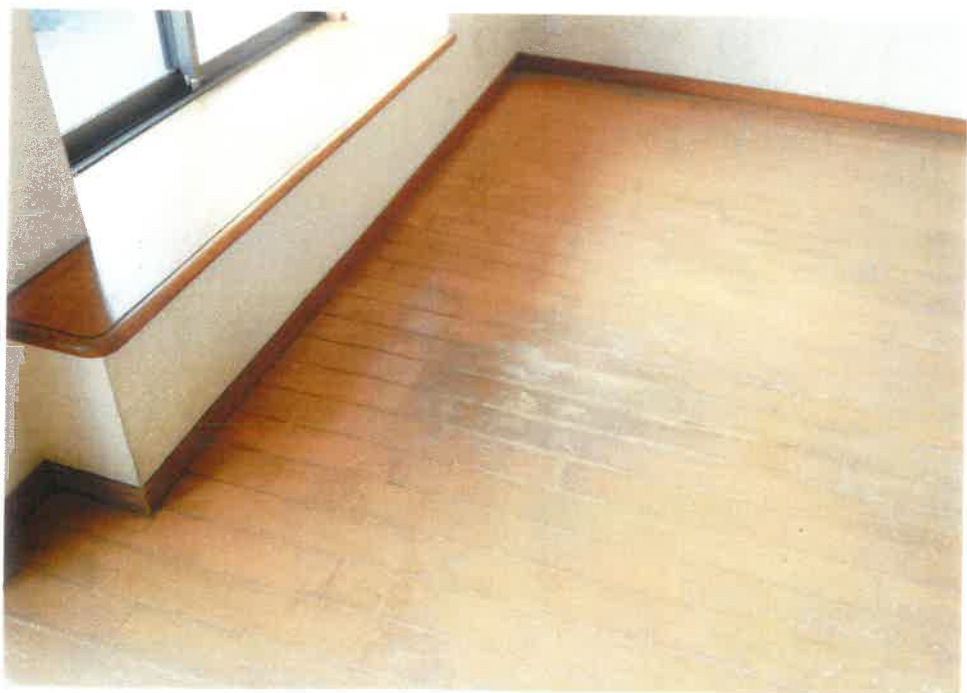
⑩ フローリングの摩耗傷
