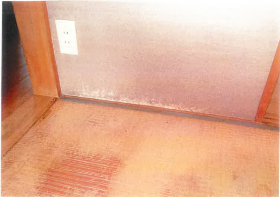
⑨ 壁面の損傷及び畳の摩耗傷（和室）
