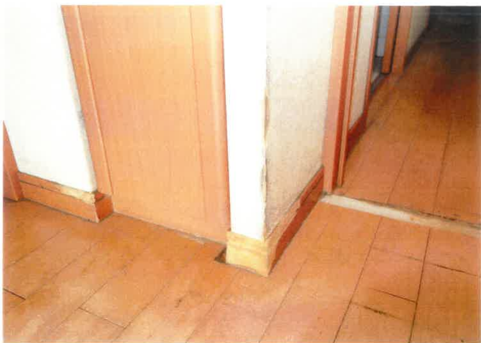
⑧ 壁面の損傷（LD）
