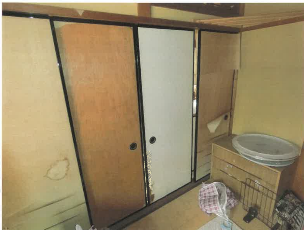
1 2 物件2建物内部の状況（建具の損傷・和室2）
