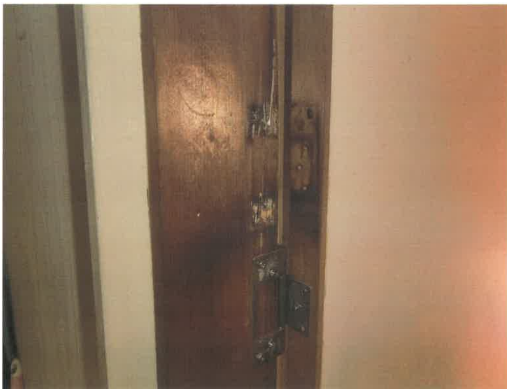
1 1 物件2建物内部の状況（柱の損傷（腐食）・脱衣洗面所）
