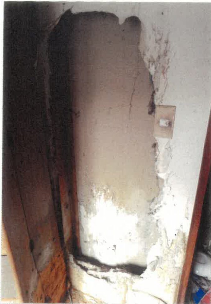
⑦ 壁面の損傷状況（洋室）
