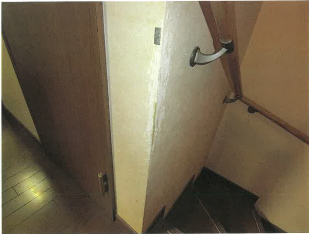
9 物件2建物内部の状況（2階廊下・クロスの損傷）
