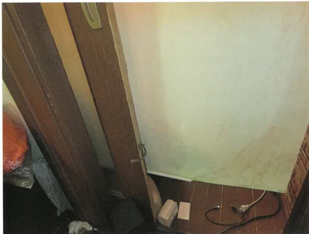
10 物件2建物内部の状況（1階廊下南側・ドア表面材の剥がれ）
