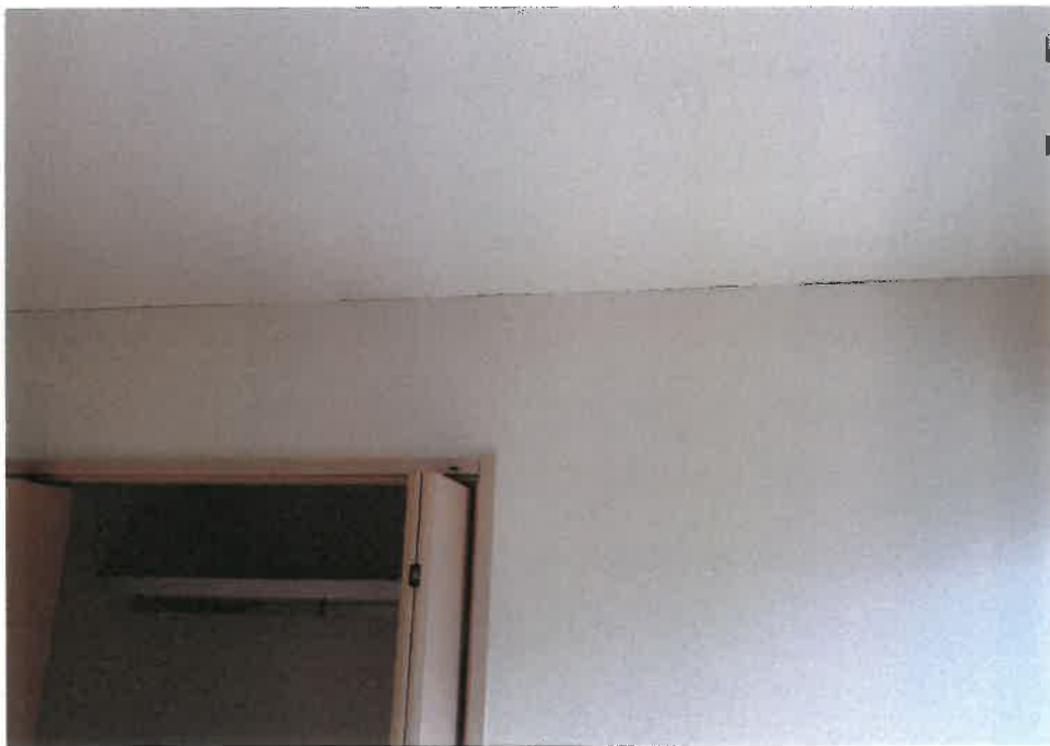
⑥ 屋内の状況（洋室3のクロスが割れている様子）
