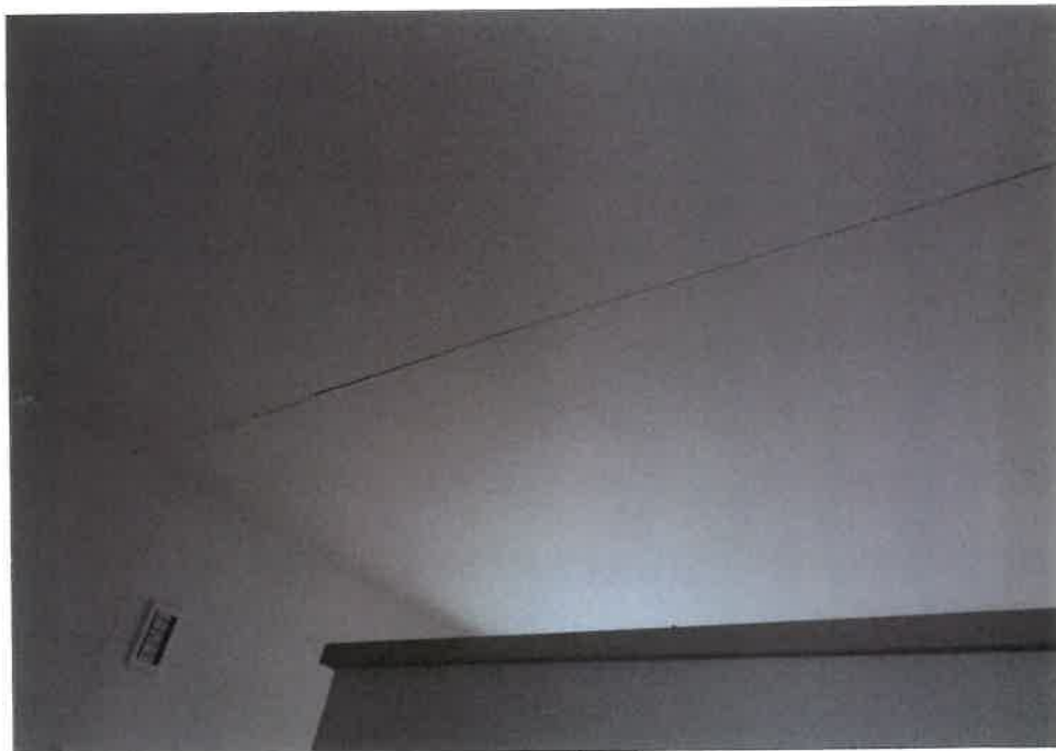
⑧ 屋内の状況（洋室1の天井のクロスが割れている様子）
