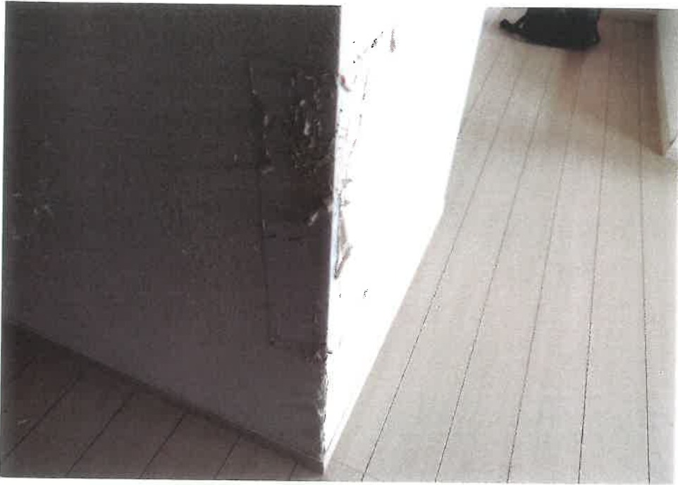
⑨ 屋内の状況（キッチン南東端の壁と接するリビングダイニング側の壁のクロスが傷んでいる様子）
