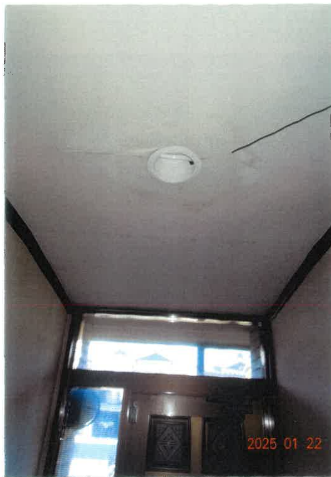
①⑨ 物件4建物屋内の状況 (1階 玄関天井の雨漏り跡)
