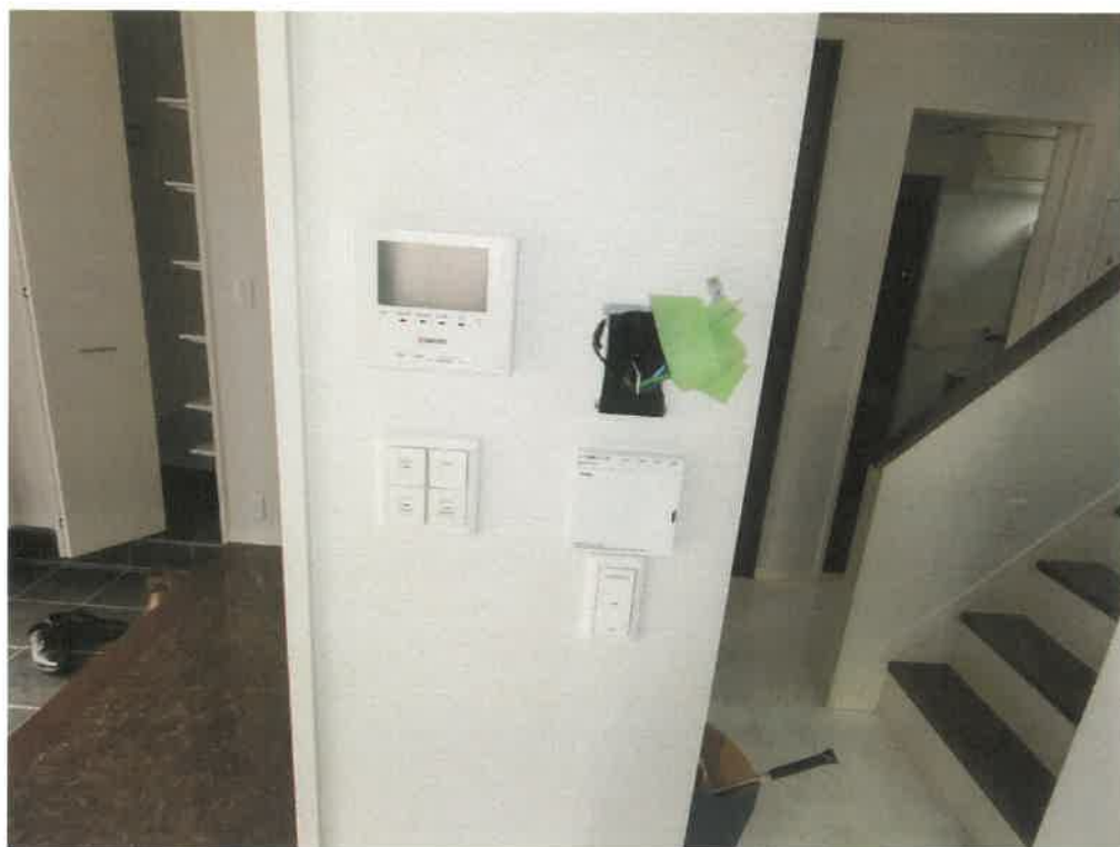
8 物件2建物内部の状況（インターホン親機の欠損（LD））
