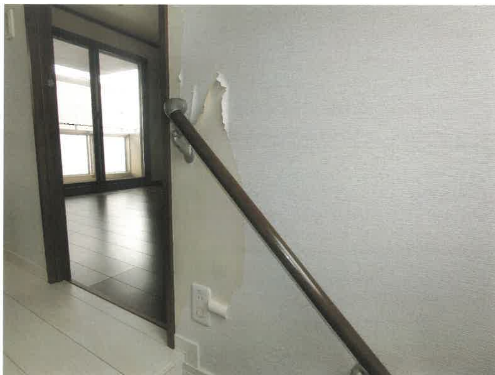
7 物件2建物内部の状況（クロスの損傷（2階階段付近））
