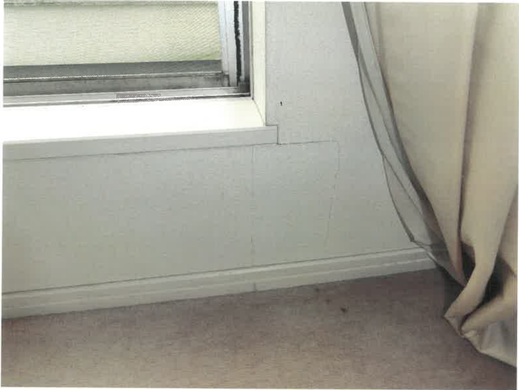
7 物件2建物内部の状況（クロスのひび・洋室①）
