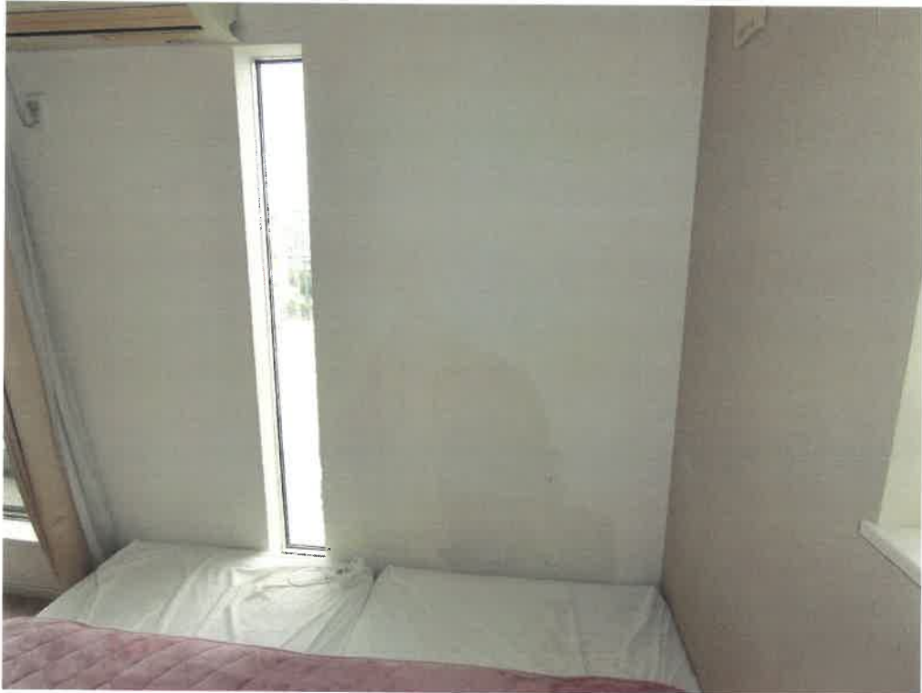
8 物件2建物内部の状況（クロスの剥がれ・洋室①）
