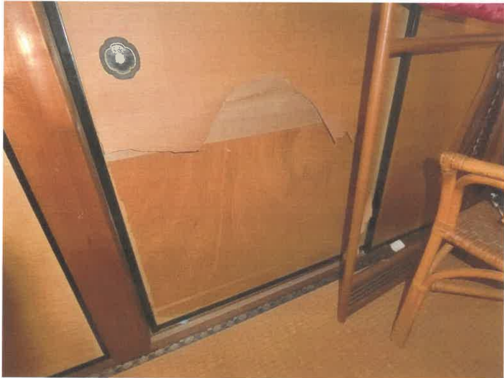
9 物件1主である建物内部の状況（建具の損傷（和室1））
