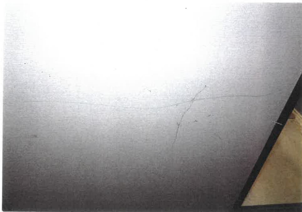
⑥ 屋内の状況（洗面室の廊下側の壁の様子）
