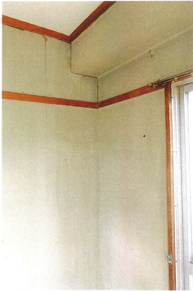
⑦ 壁面のシミの状況（和室③）
