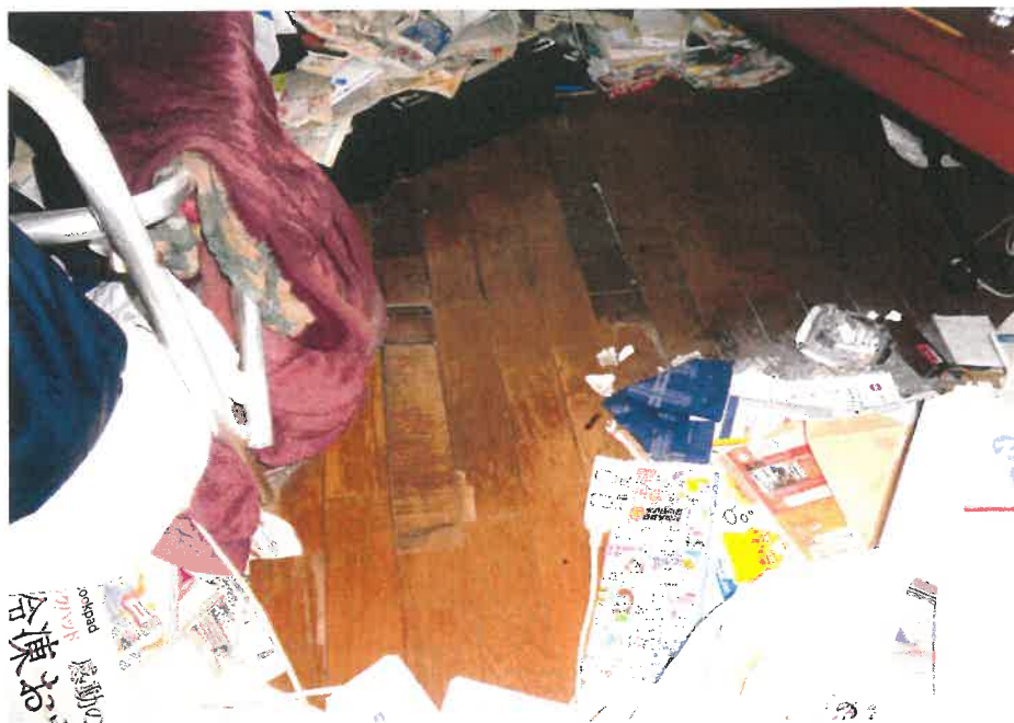
屋内の状況 居間・食堂 床の破損等
