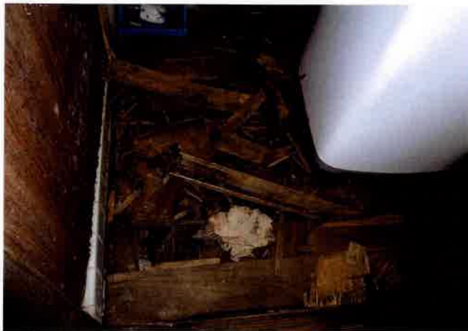
⑪屋内の状況 洗面の床の 状況 (物件7) (主である 建物)
