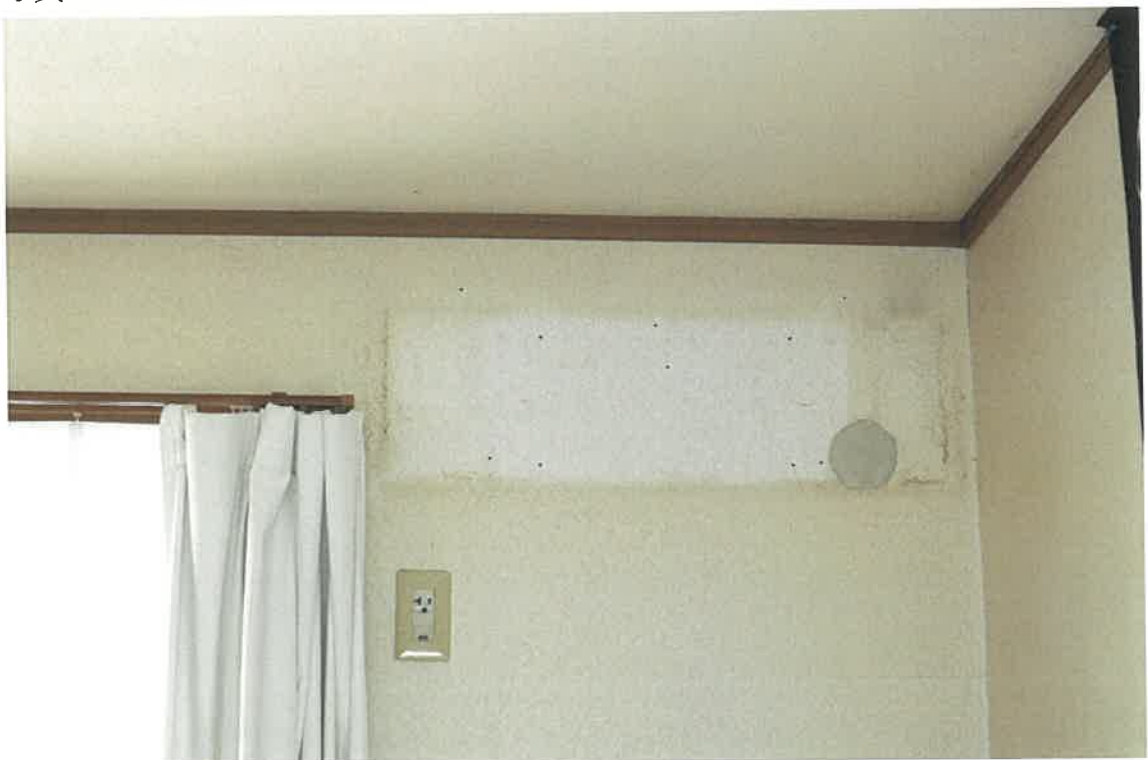
物件 2 建物 2 階南西側洋室内の壁の損傷箇所
