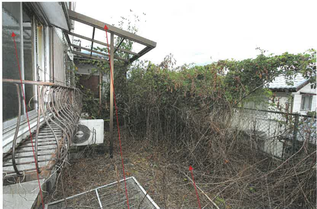
物件 2 建物 壊れた庇 物件 1 土地
