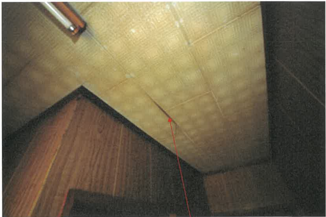
物件 2 建物 2 階室内 天井の剥がれ
