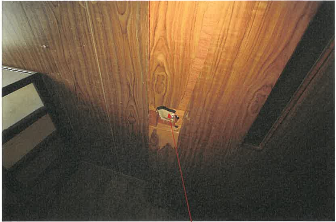
物件 2 建物 2 階室内 ドアノブがない
