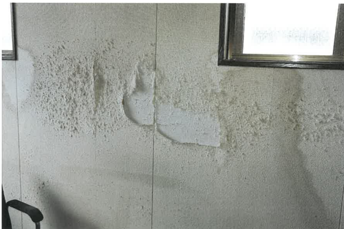
物件 2 建物 1 階事務所壁クロスの損傷箇所
