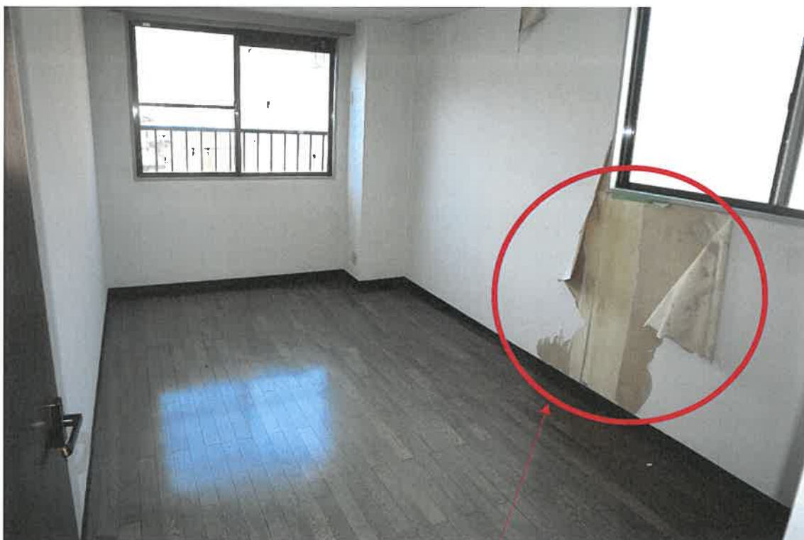
壁クロスの損傷状況
