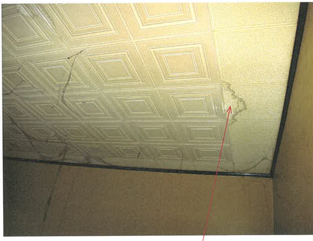
前同建物の1階室内（天井の染み）
