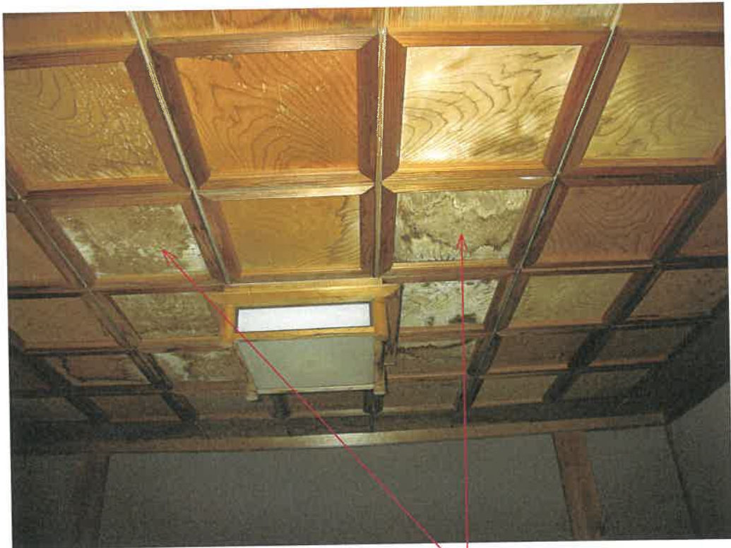
前同建物の1階玄関（天井の染み）
