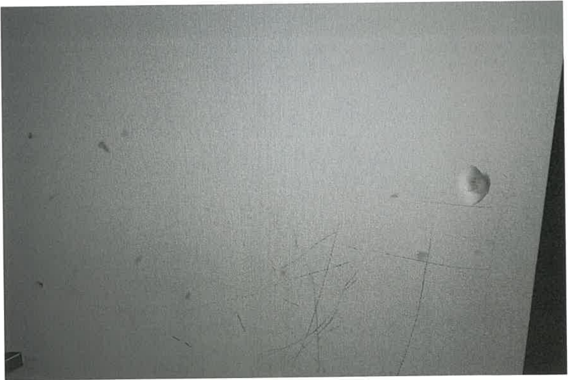
玄関ホールの壁の損傷状況
