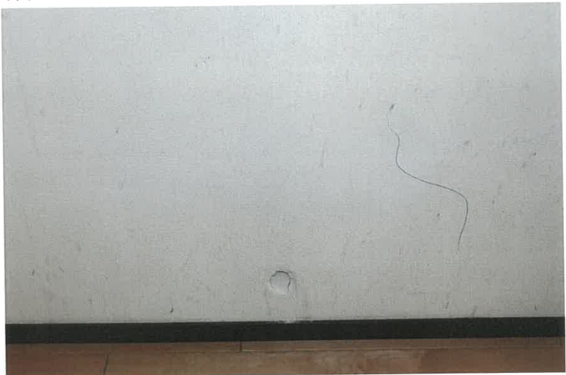
1 階LDKの壁の損傷状況
