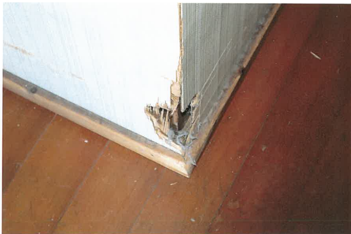
物件 7 附属建物 2 廊下の壁の損傷箇所
