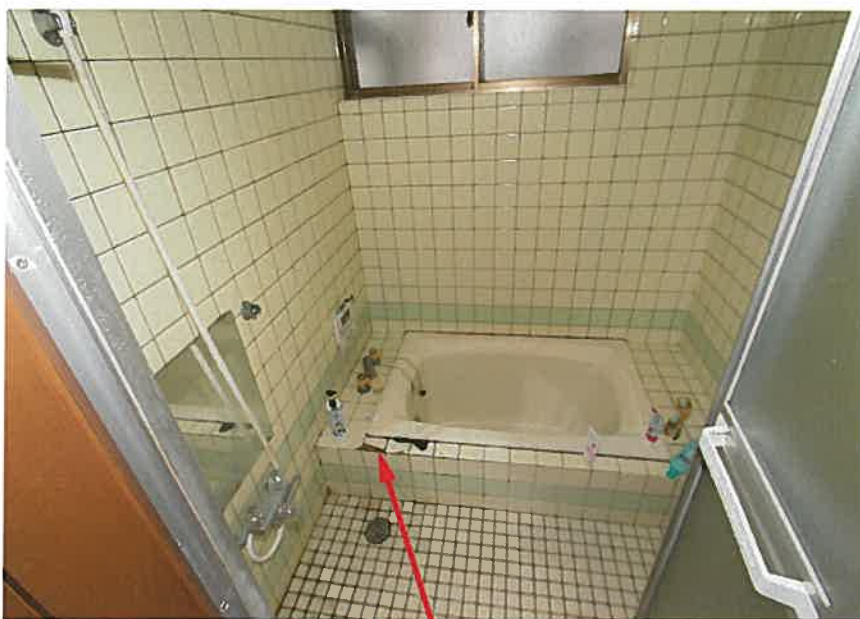
タイルの損傷
