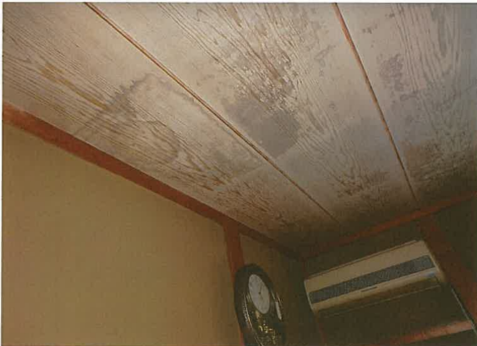
2階和室（中央付近）の天井の状況
