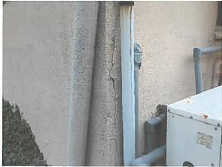
写真7 外壁のクラック
