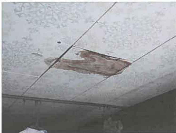
写真19 雨漏りによるものと思われる染み
