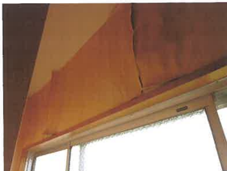
写真6 (本件建物 1階 (壁紙が傷んでいる状況))
