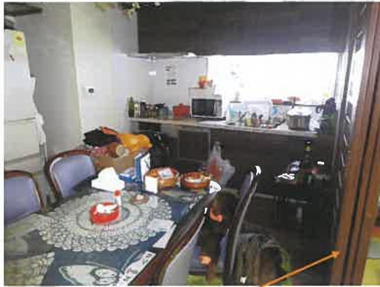
建て付けが悪くなっている引き戸
