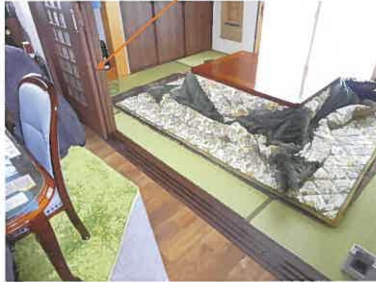
写真5 (本件建物 1階) 建て付けが悪くなっている引き戸
