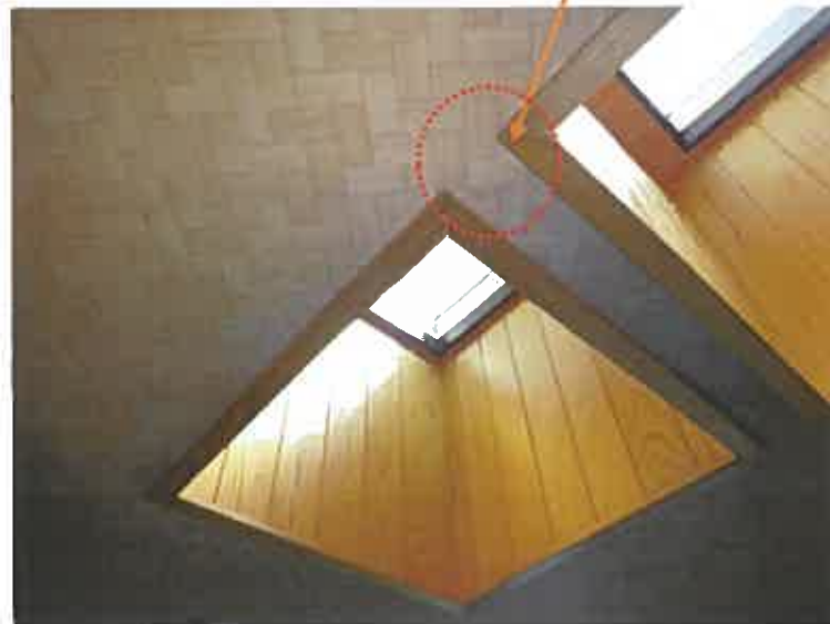
写真6 (本件建物 1階天井部分) 雨漏りがした形跡がある箇所
