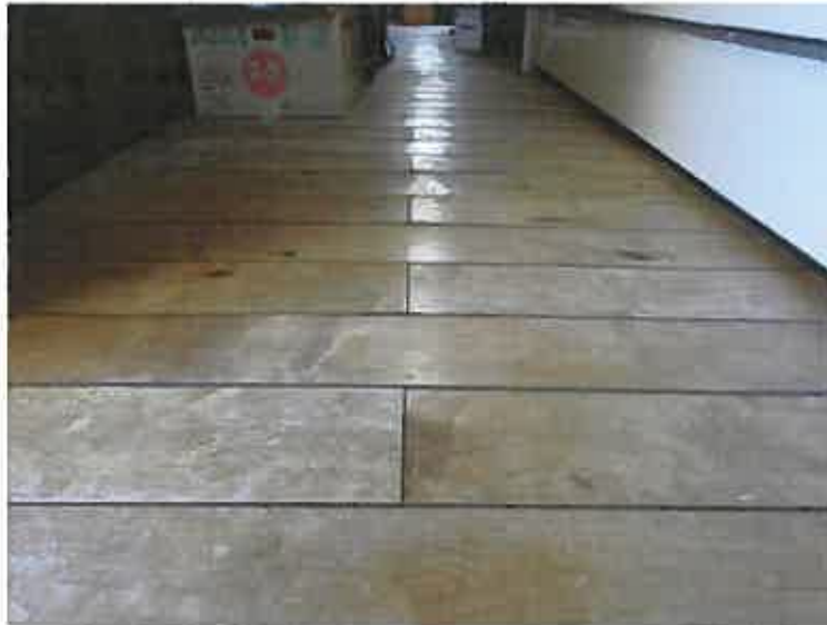
写真10 (本件建物 2階 (写真9の床板の状況))
