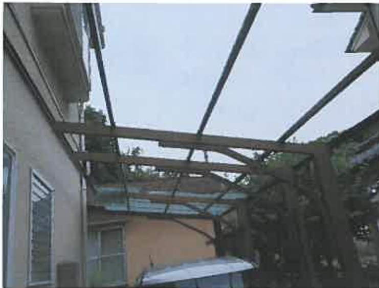
写真4 カーポート屋根板の剥がれ
