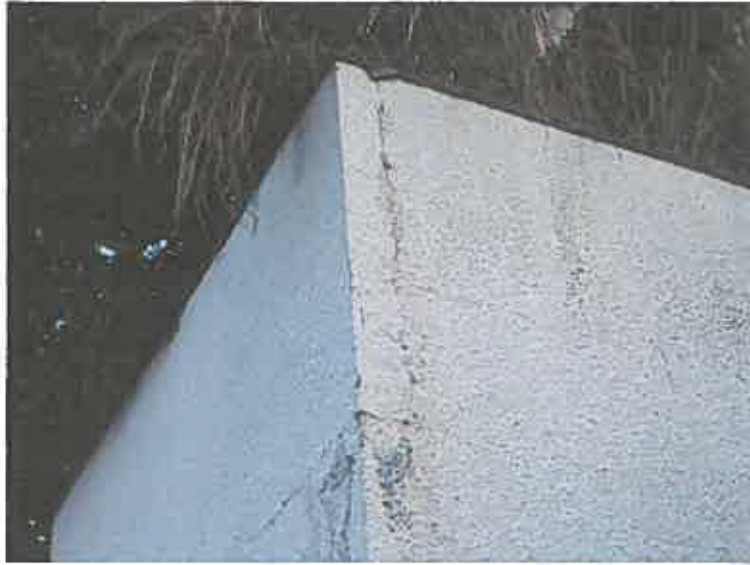
写真4 コンクリート塀のクラック
