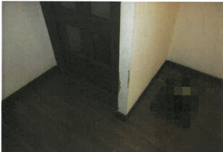
写真17 1階廊下（壁部分・キズ）
