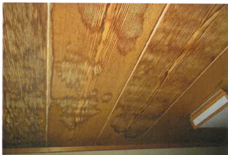
写真1 5 1階広縁（天井部分・雨漏り）
