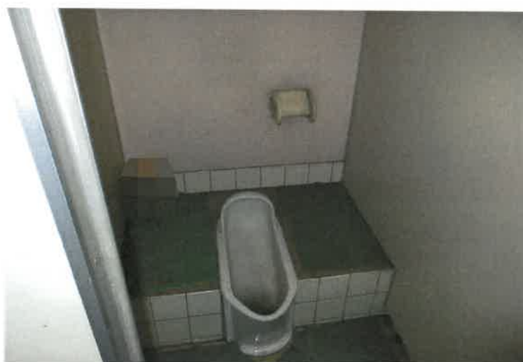
写真14 2階トイレ（洗面所側）
