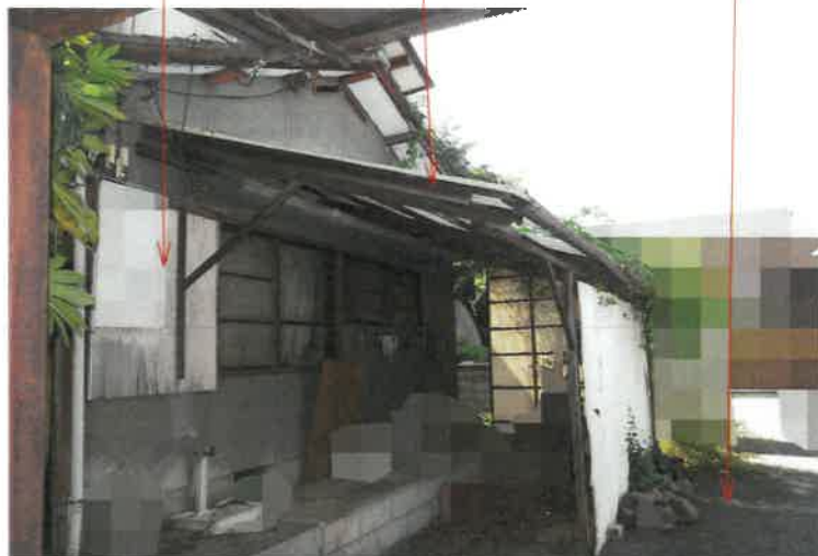
写真4 物件2建物 下屋 物件1土地
