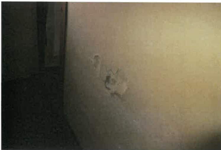
写真 2 1 2 階廊下(洋室側壁凹み)
