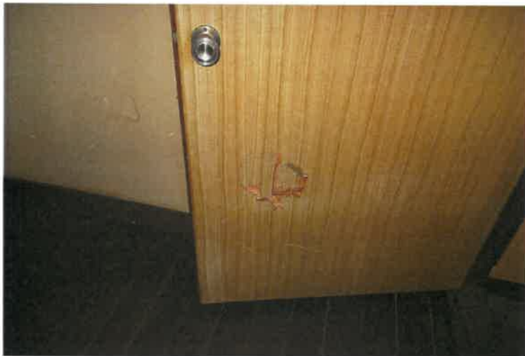
写真 2 0 2 階洋室ドア凹み
