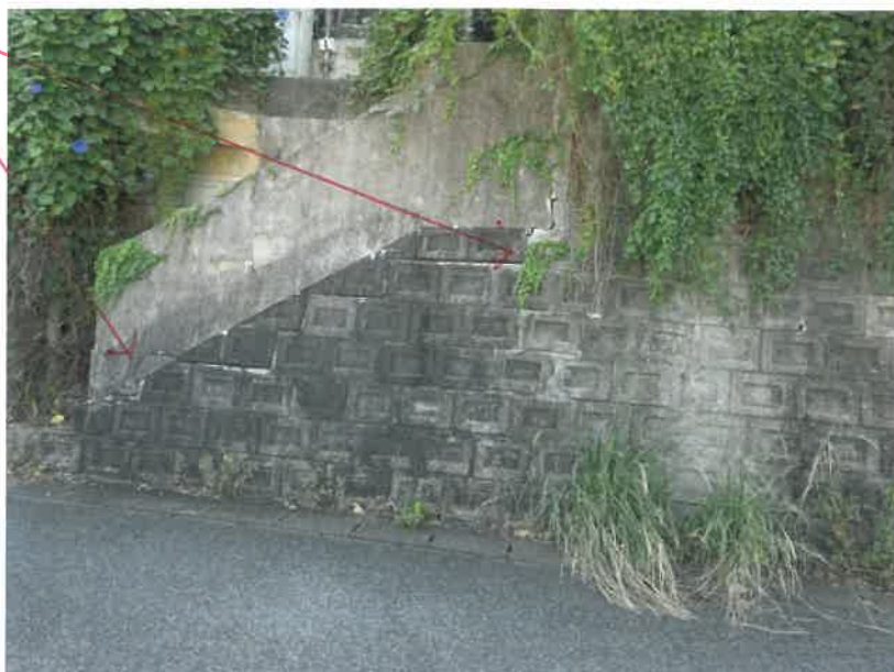
9 擁壁のひび割れ
