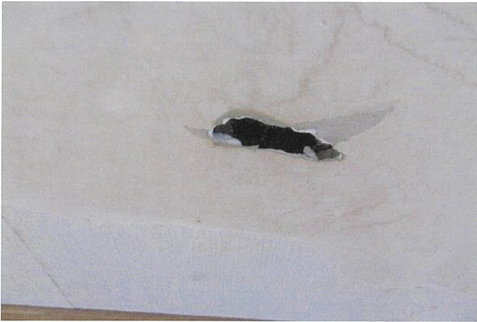
No. 10 壁の損傷状況を撮影
