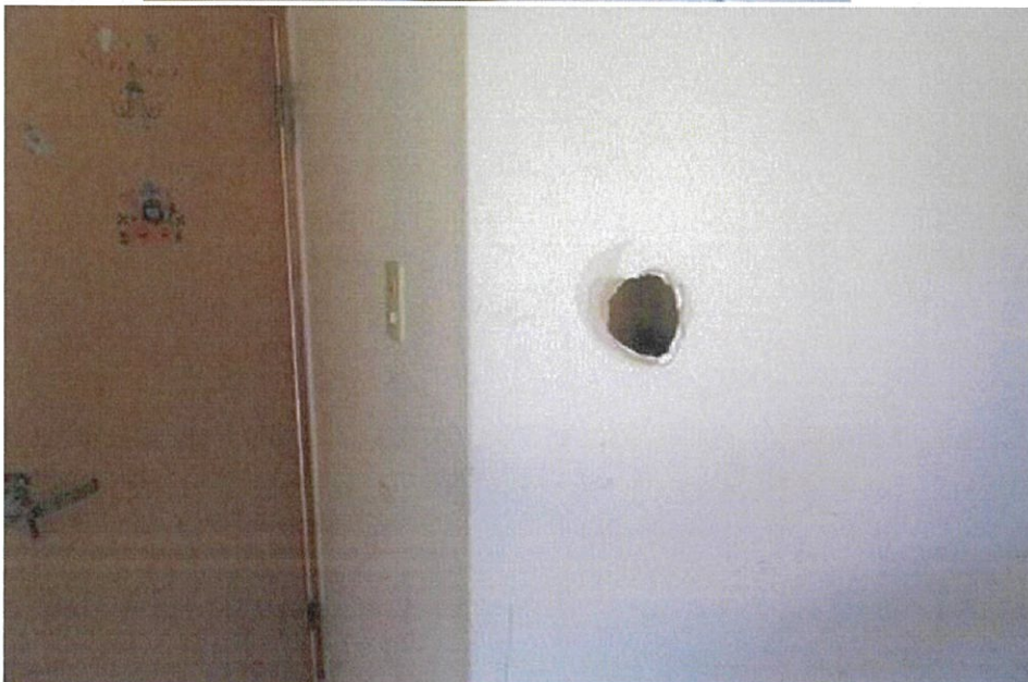
No. 12 壁の損傷状況を撮影
