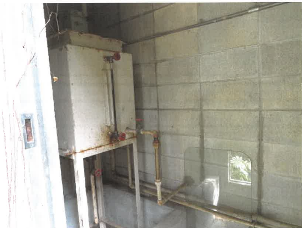
(写真 5 8) …符号 1 1・機械室
