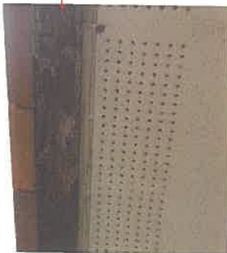
水腐れによる損傷(ベランダ床面(LDK側))
