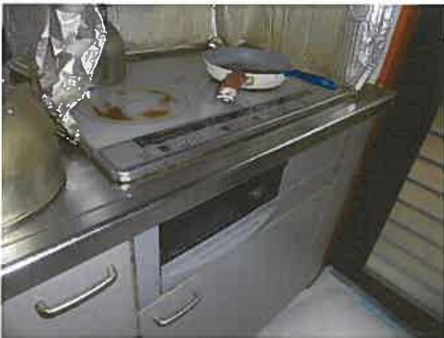
I Hコンロの固着状況
