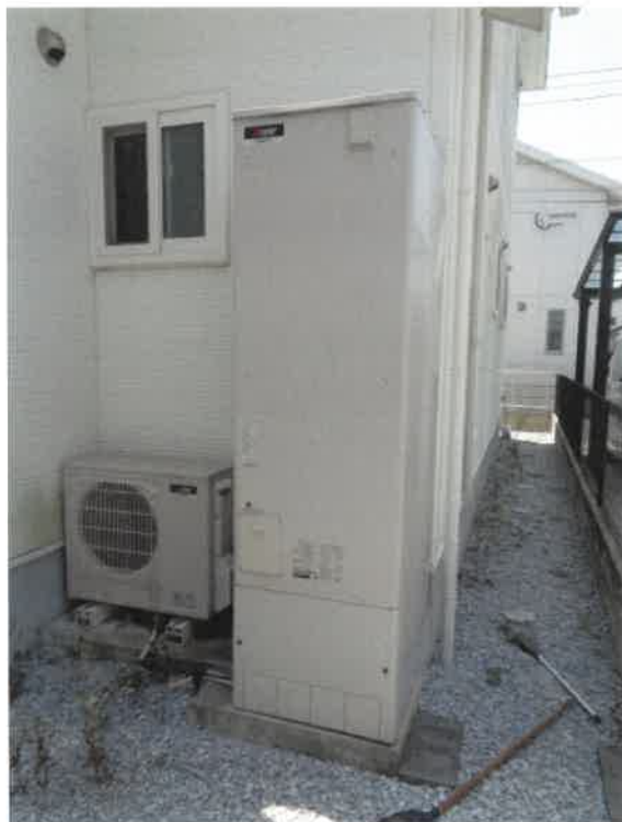
(写真 3) 売却対象物件（従物）であるヒートポンプ式給湯機
