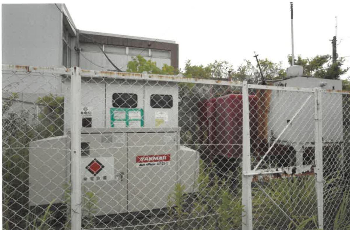
(写真④) 本件建物のキュービクル等(売却対象外PCB保管場所)
