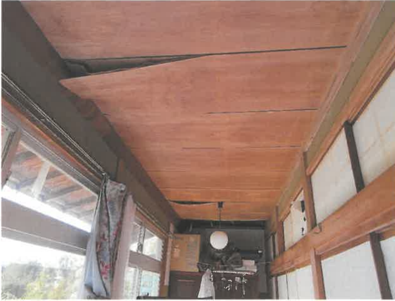
物件 2 天井の板の剥がれ
