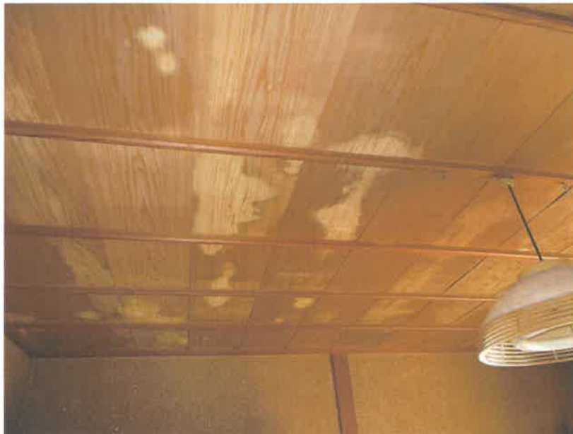
物件 2 天井の雨漏り
