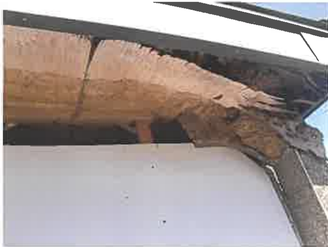
物件 2 の庇の腐食箇所
