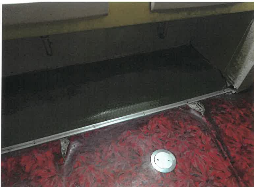
写真14 クロスの傷み
