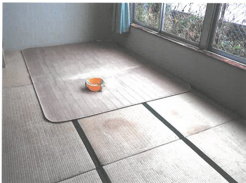
物件4 雨漏りの状況
