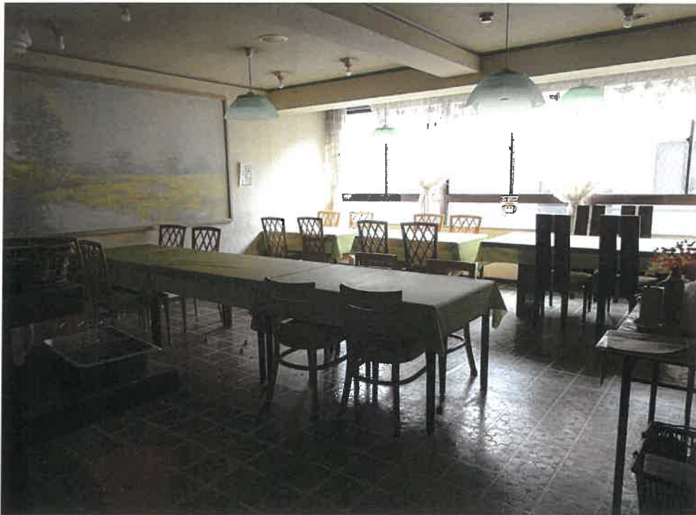
写真24 2階食堂内の壁クロスの傷み
