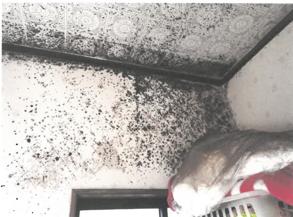
物件6 カビの発生状況
